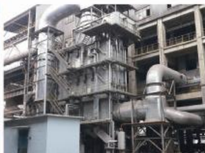
烧结余热锅炉
